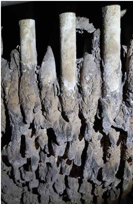
Ablagerungen am Durchtrittsgitter eines Biomasse-HKW
