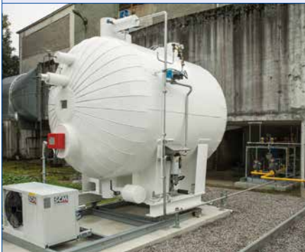
CO 2 -Tank mit Pumpenskid
